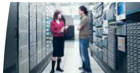
Centros de dados: servidores de aplicativos, centros de comunicações, unidades de armazenamento de dados, elementos activos de redes.
